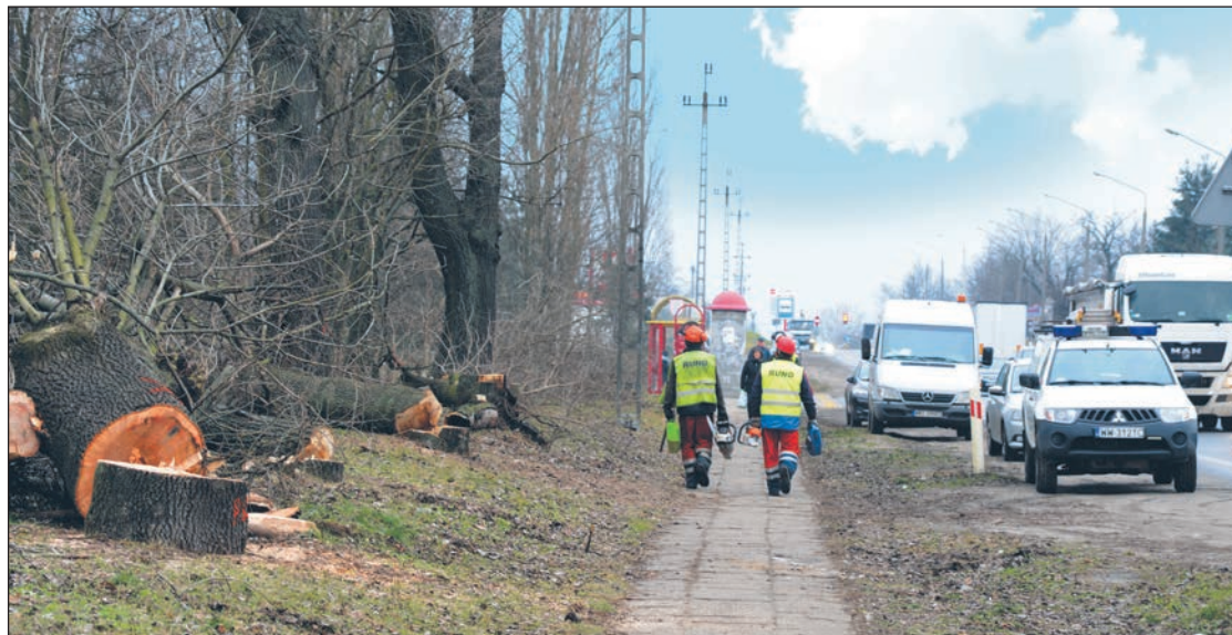
W połowie stycznia br. rozpoczęła się wycinka drzew pod przebudowę drogi krajowej nr 61 na odcinku do ul. Wolskiej. Kolejnym krokiem będzie usuwanie kolizji w infrastrukturze podziemnej. W ciągu 5 lat zaplanowano przebudowę DK 61 aż do ronda w Zegrzu Południowym
