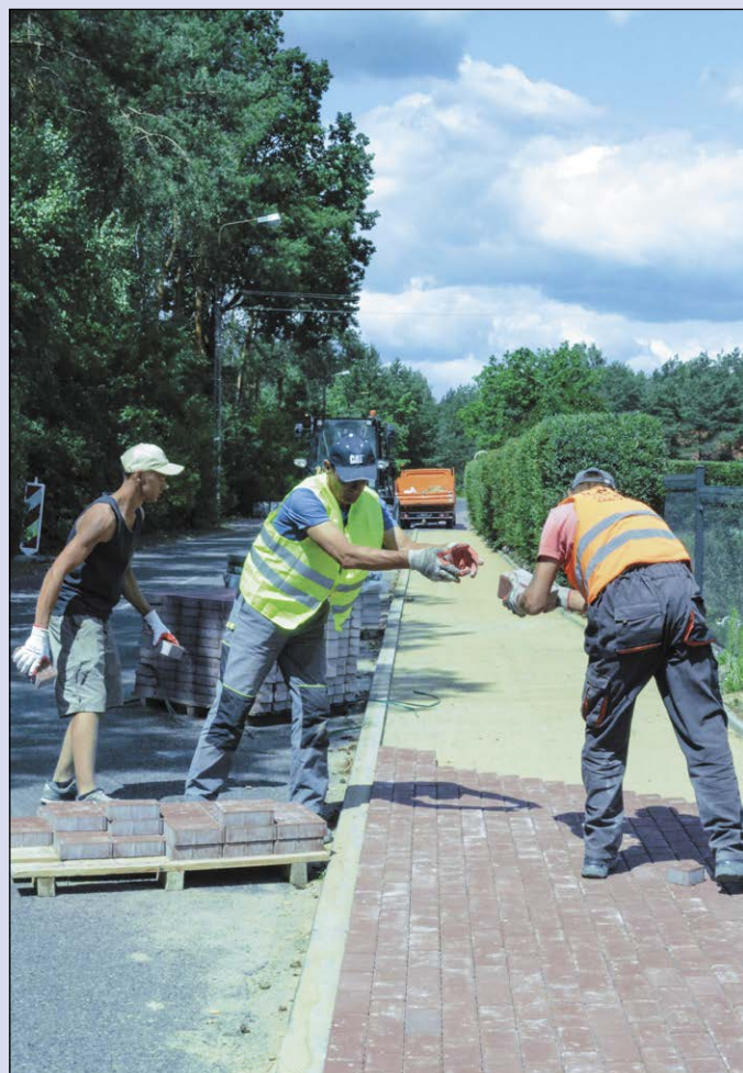
Na wszystkie prace inwestycyjne Powiat otrzymuje gwarancję wykonawcy. W przypadku chodnika w Komornicy zaistniała konieczność skorzystania z niej i wymiany nawierzchni
