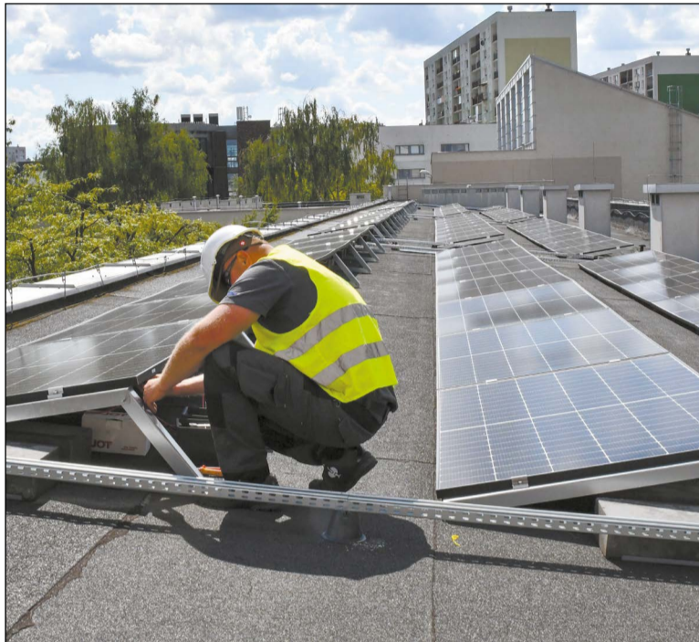
Jako pierwszą z zaplanowanych przez Powiat Legionowski inwestycji, mających na celu obniżenie kosztów zużycia energii, zrealizowano instalację paneli fotowoltaicznych na dachu budynku Liceum Ogólnokształcącego im. Marii Konopnickiej w Legionowie
