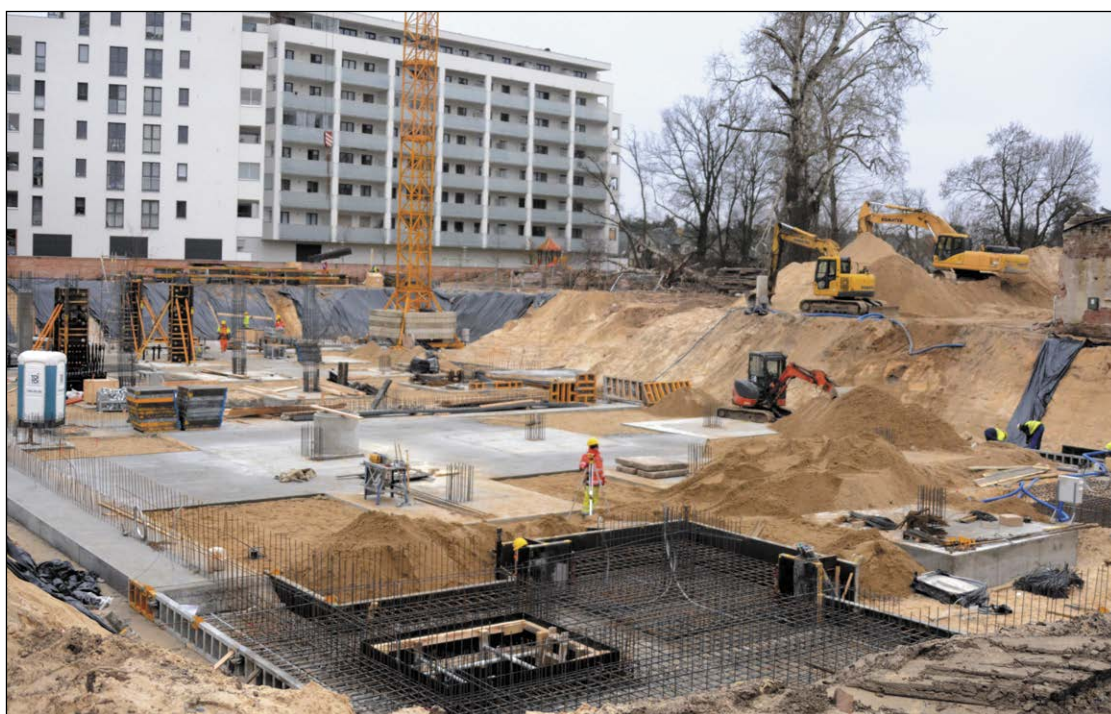
Wykonawca robót nie zwalnia tempa, prace związane z budową szpitala w Legionowie przebiegają bez zakłóceń
