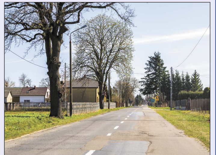
Inwestycja znacząco wpłynie na poprawę bezpieczeństwa użytkowników drogi. Spękana nawierzchnia jezdni z wieloma wyłomami ulega postępującej degradacji i wymaga remontu
