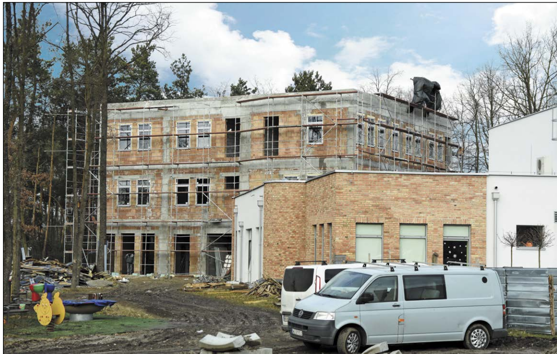
Postępy prac przy budowie Centrum Poradnictwa i Wczesnego Wspomagania Rozwoju Dziecka widoczne są z tygodnia na tydzień
