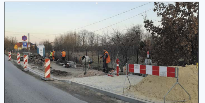
Urządzenia, dzięki którym woda odprowadzana jest do przydrożnego rowu, budowane są w miejscach, gdzie podczas opadów na jezdni powstają kałuże
