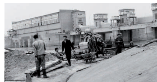
fot. Archiwum „Hydroprojektu”
