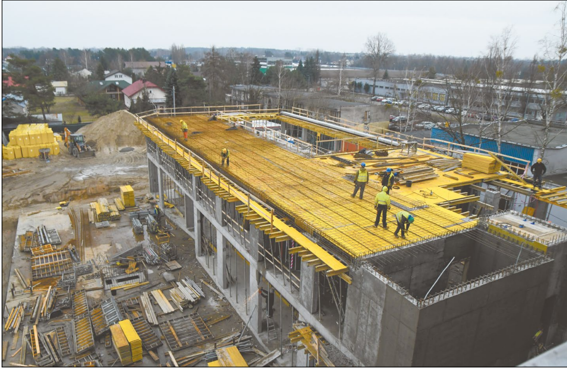
Prace przy budowie Centrum Usług Społecznych przebiegają zgodnie z harmonogramem. Do końca lutego zakończone zostaną roboty przy wykonaniu stropu na I piętrze
